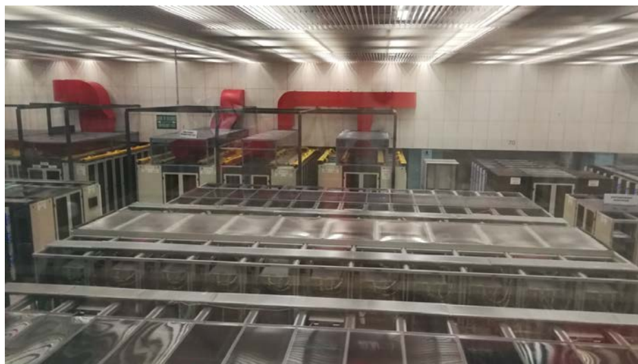
ภาพที่ 42 ภายใน Data Center
