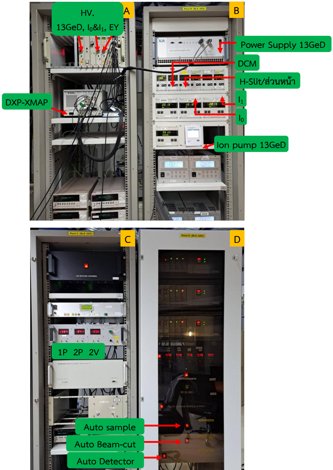
รูปที่ 5 ตู้ Rank A, B, C และ D ของสถานีทดลองที่ติดตั้ง Hardware อุปกรณ์ควบคุมต่าง ๆ
