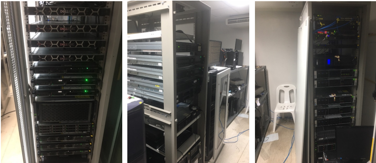
รูปที่ 14 ศูนย์ข้อมูล (Data Center)
