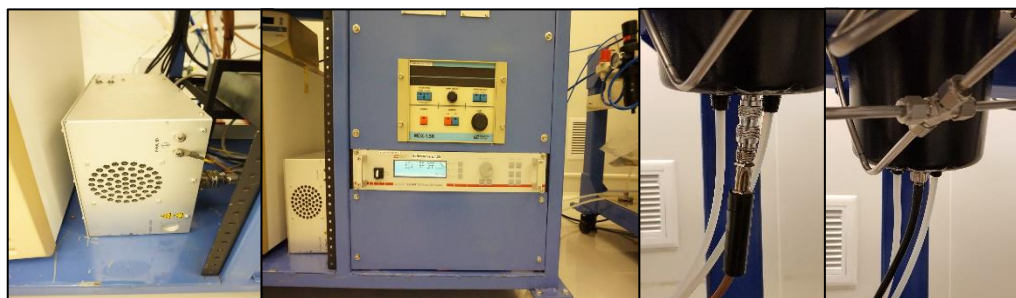
ภาพที่ 7 แสดงเครื่อง กำเนิดไฟฟ้า (Generator)
